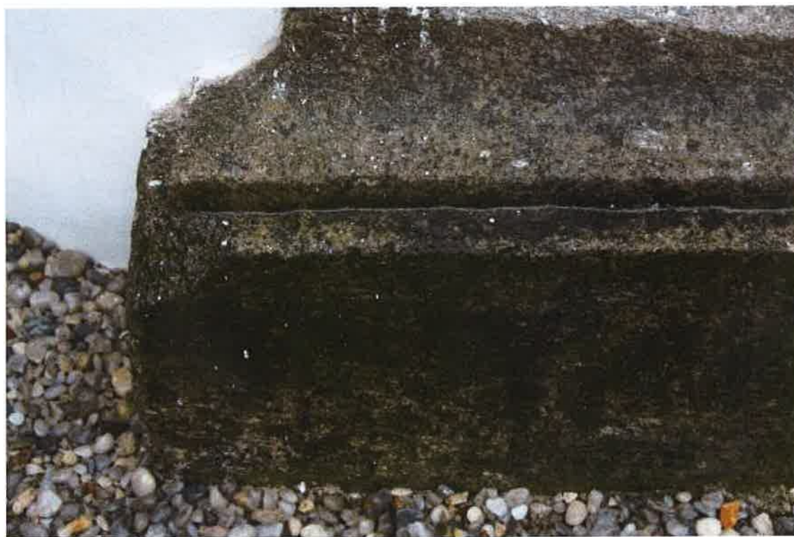
Výklenková kaple č. 4 – stékající srážková voda, povrchové nečistoty, pyl a jiné organické produkty vytvořily vlhkostní mikroklima a následné podmínky pro biologická napadení mechy a lišejníky; detail soklu
