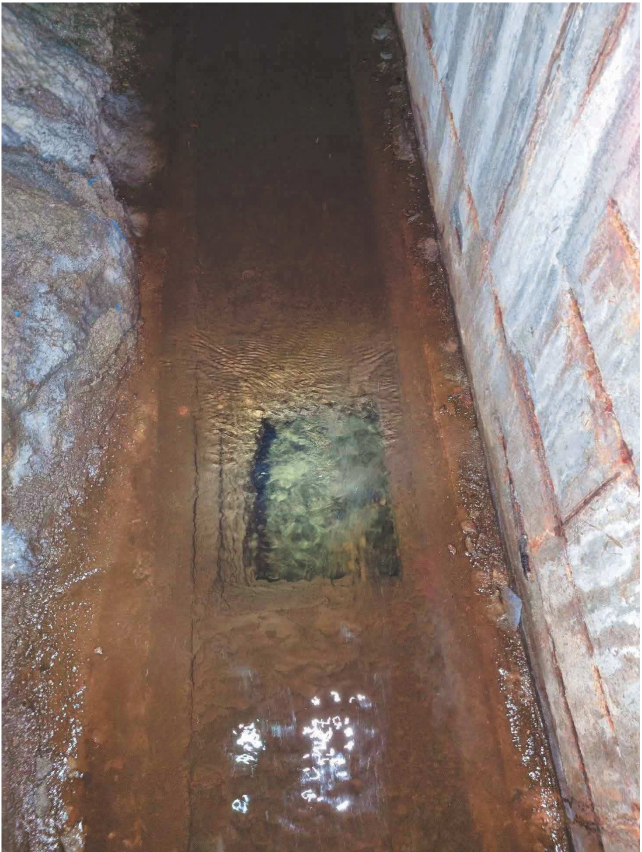
Obrázek 8: Obchvatný kanál Větrní - Č. Krumlov, chybějící poklop odvodňovacího systému
