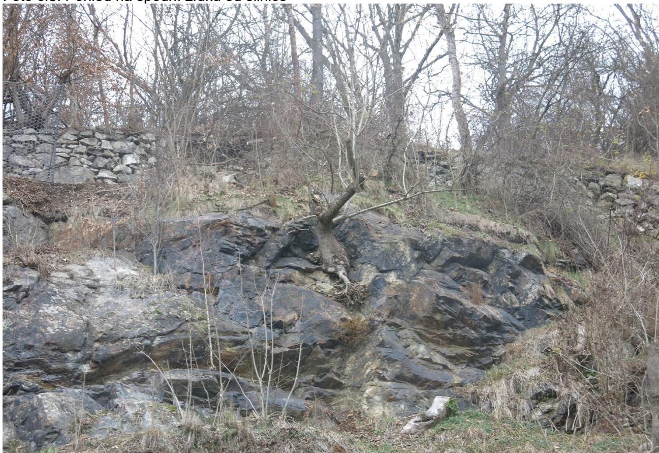
Foto č.4: Stabilitu narušují kořeny náletové vegetace.
