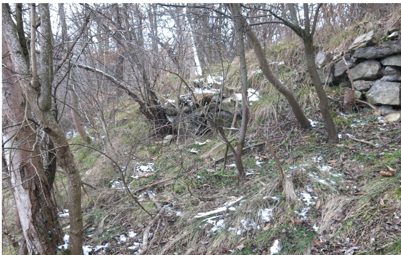
Foto č.7: Poškozené zdi na horní hraně s náletovou vegetací
