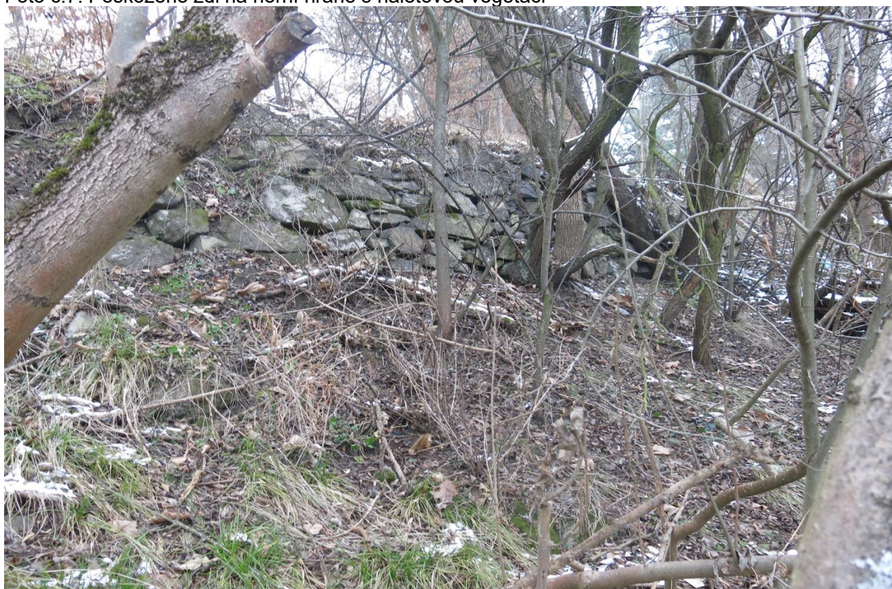
Foto č.8: Poškozené zídky na horní hraně pozemku.
