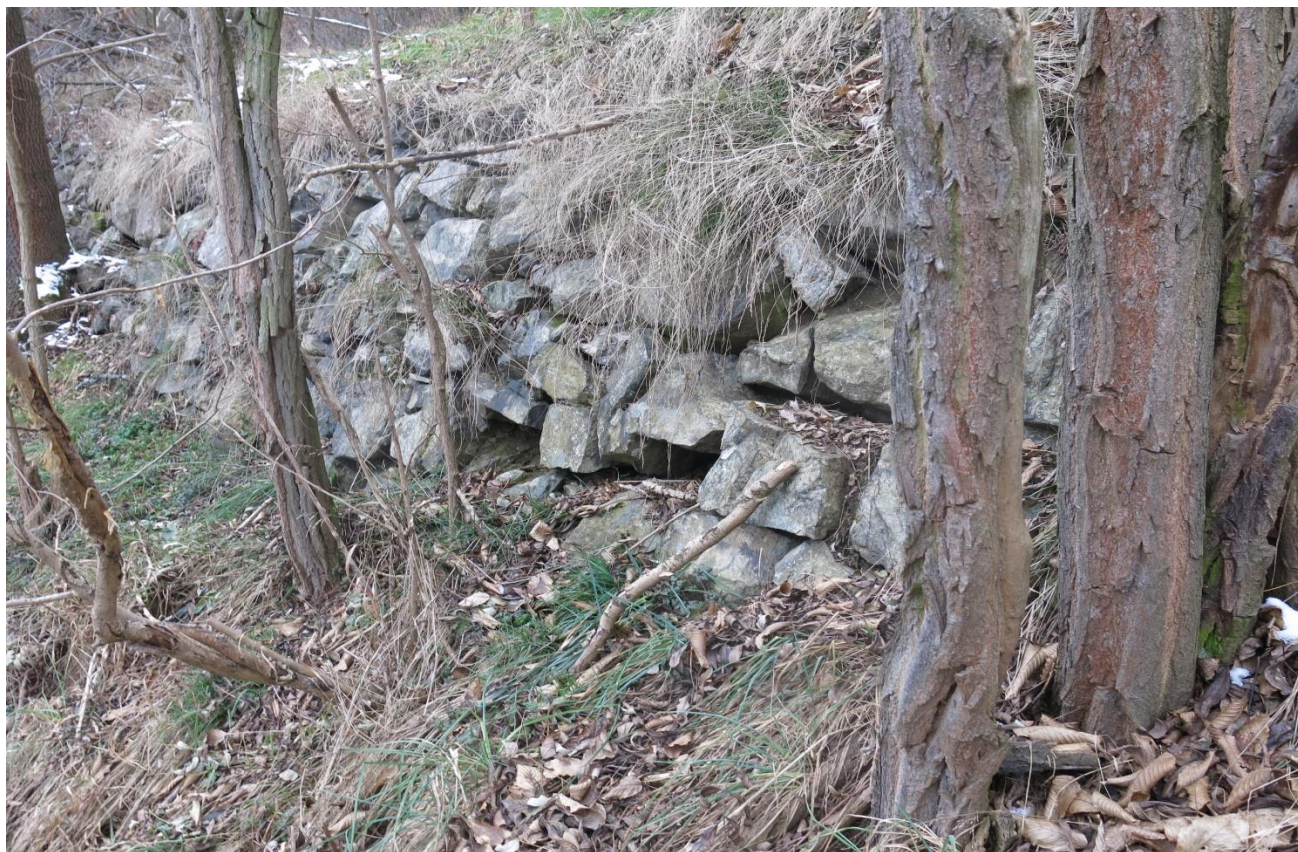
Foto č.11: Pohled na nestabilní část spodní zídky.
