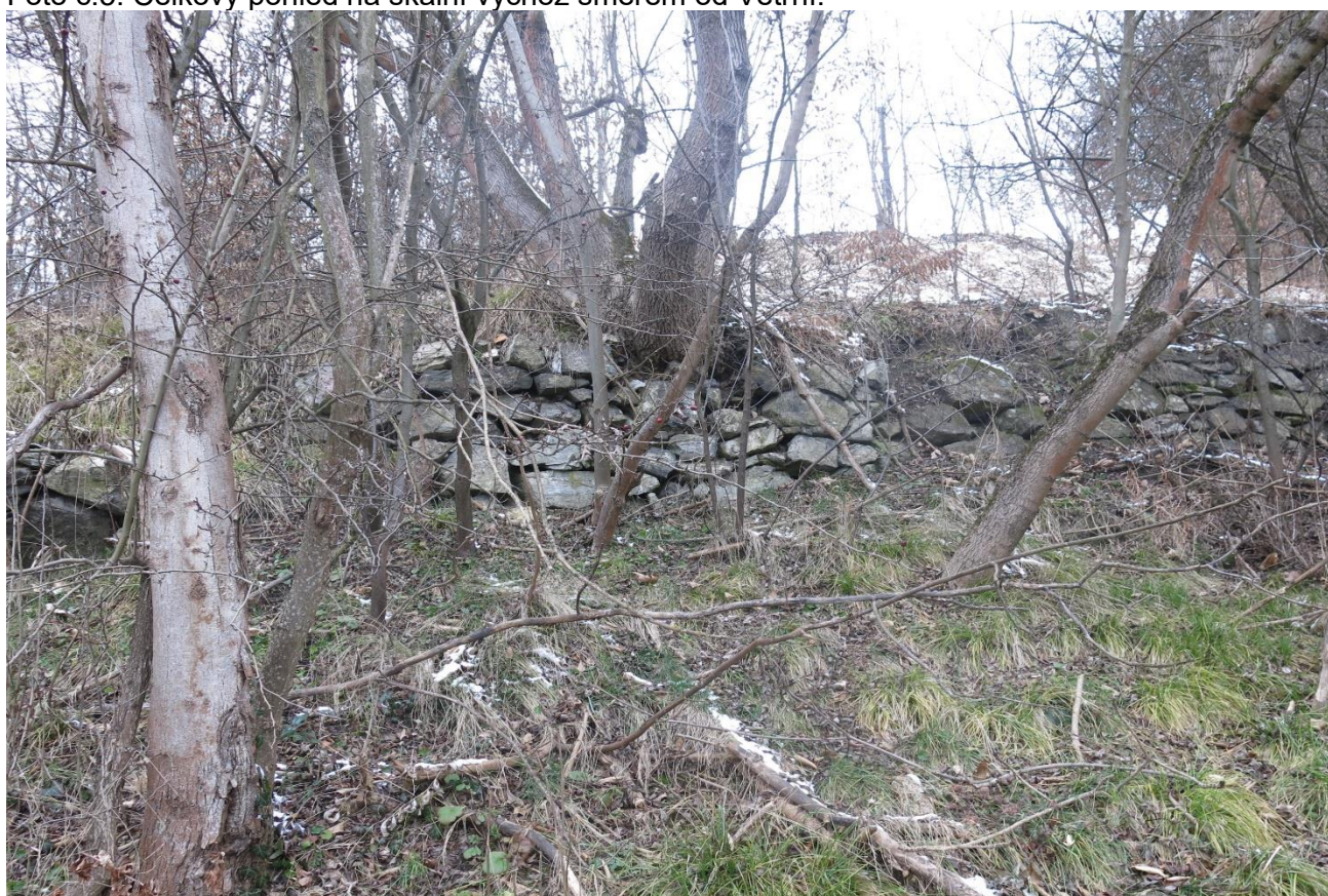
Foto č.6: Poškozená zídka ne horní hraně.
