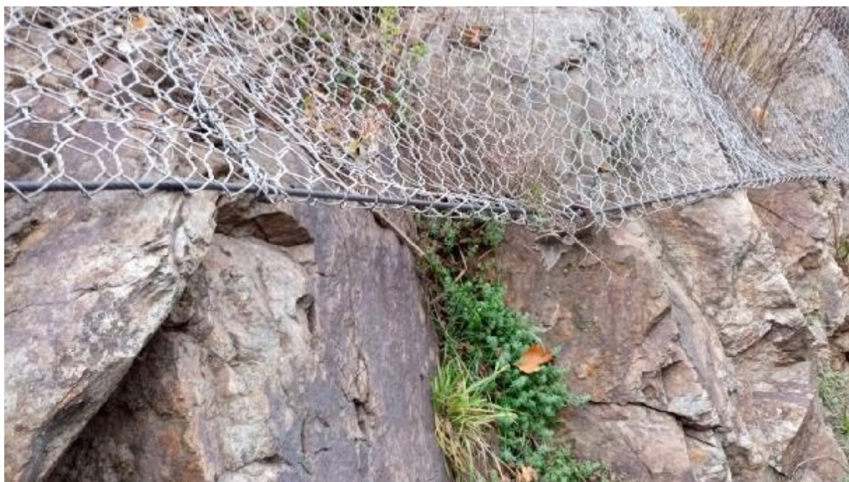
Obr. 9 Pohled na spodní horizont obvodového ocelového lana, který nedostatečně kopíruje povrch terénu
