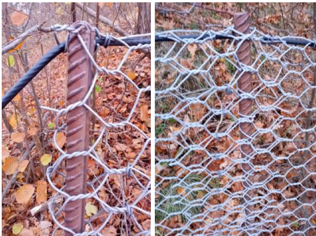
Obr. 16 Pohled na sloupek záchytného plotu a překryv sítě s jednou svislou řadou C kroužků
