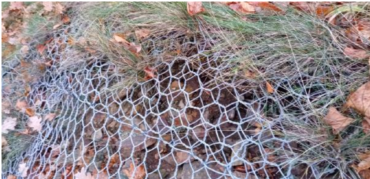
Obr. 13 Pohled na část přehybu ocelové sítě s chybějící druhou řadou C kroužků
