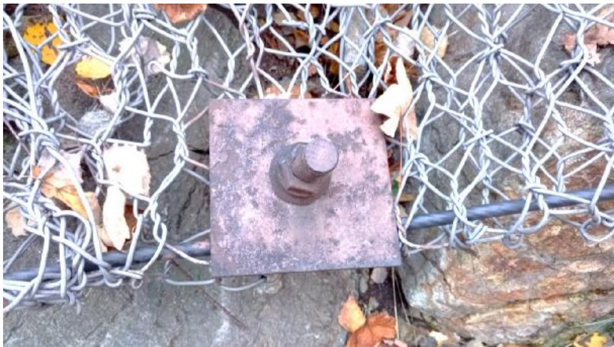
Obr. 4 Detail systémového kotevního svorníku, roznášecí desky, sítě a obvodového ocelového lana s potahem z PVC
