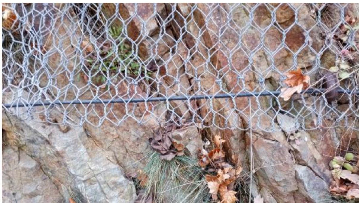
Obr. 6 Pohled na nedostatečně přehnutou ocelovou síť přes spodní horizont obvodového ocelového lana
