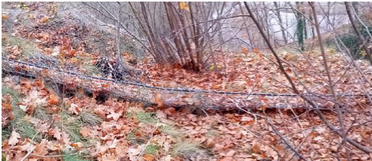
Obr. 10 Pohled na vrchní horizont obvodového ocelového lana, který nedostatečně kopíruje terén
