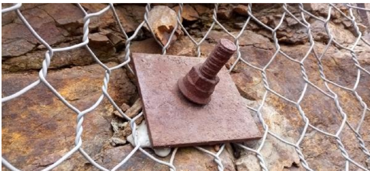
Obr. 11 Stav antikoroziční ochrany v podobě nátěru na systémových kotevních prvcích
