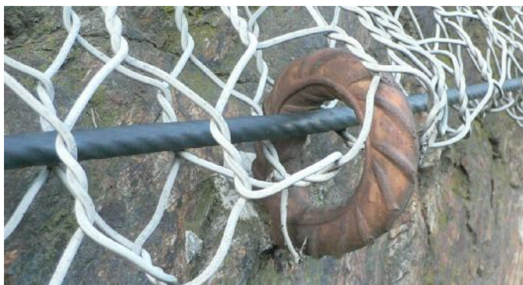
Obr. 12 Stav antikoroziční ochrany na svornících s kutým okem (chybějící nátěr, počátek koroze)
