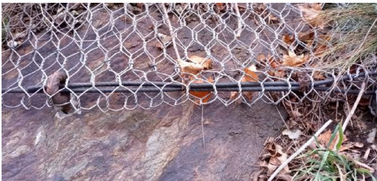
Obr. 15 Pohled na nesprávně instalované lanové svěrky s povrchovou korozní vrstvou na maticích a třmenech
