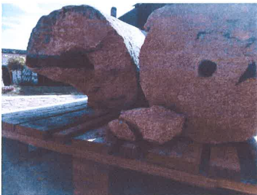
Obrázek 5 – Detail rezivějícího čepu
