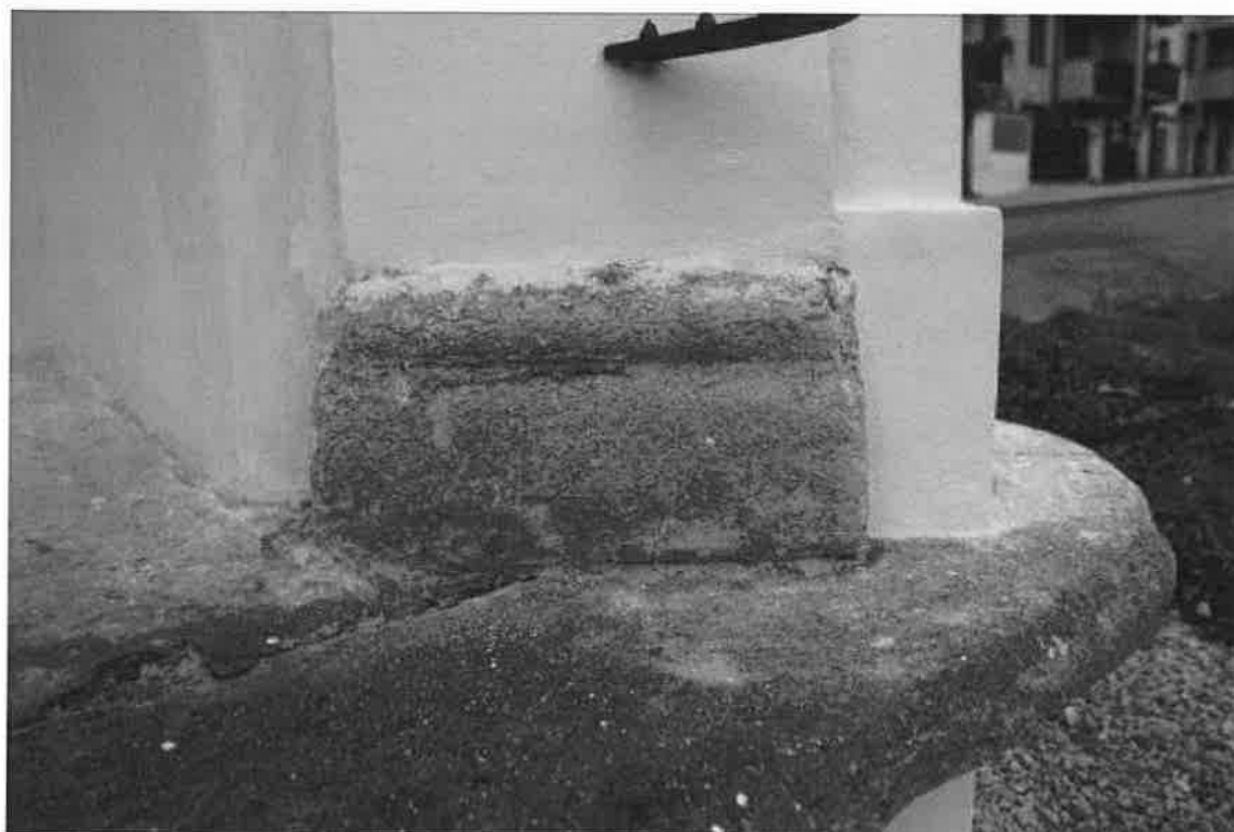
Výklenková kaple č. 1 – celkovou degradaci kamenného materiálu lze klasifikovat jako vysokou, s následnou ztrátou plastického tvarosloví; detail pohledově levé a pravé patky
